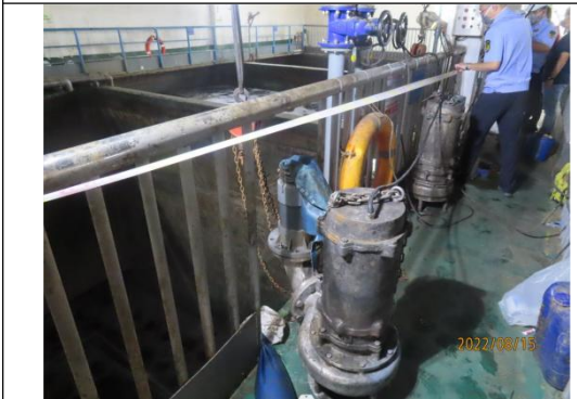
图 9：池北侧过道两台潜水泵
